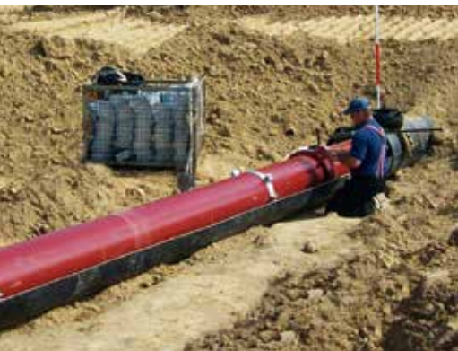
Conductele din fontă ductilă cu DN 400 cu legături mufate VRS®-T/BLS®, împinsă într-o zonă cu tuburi protectoare
