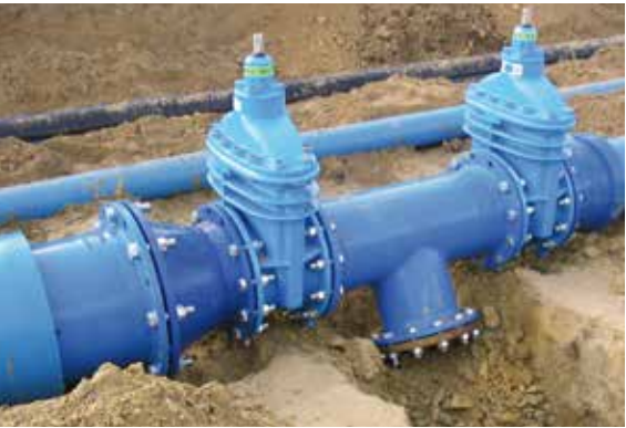
Conductă de stingere a incendiilor dotată cu robineți cu sertar
