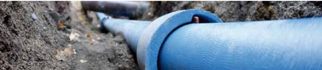
Conductă cu îmbinări VRS®-T/BLS® utilizată pentru apa de stingere a incendiilor dintr-un tunel
