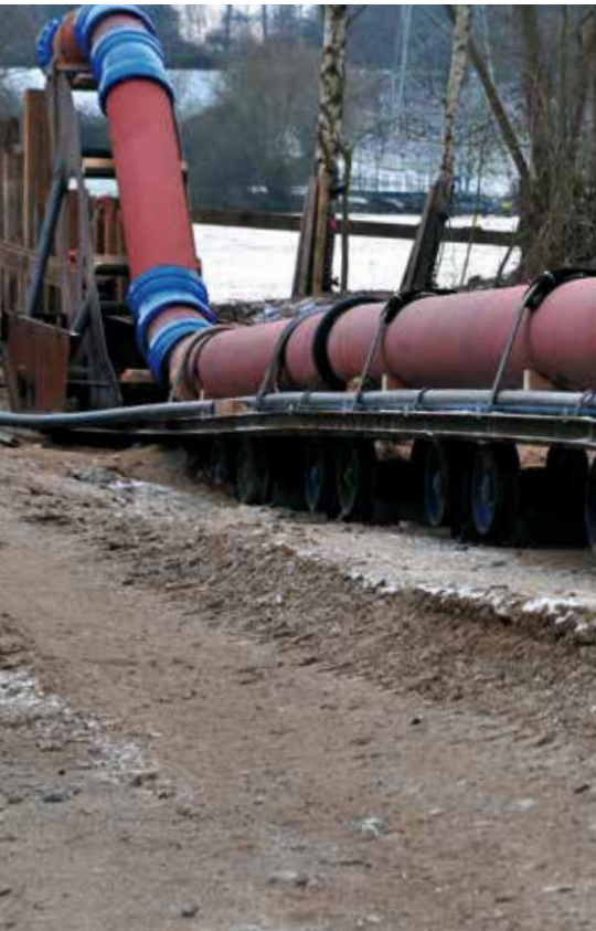
Conductă de canal de scurgere
